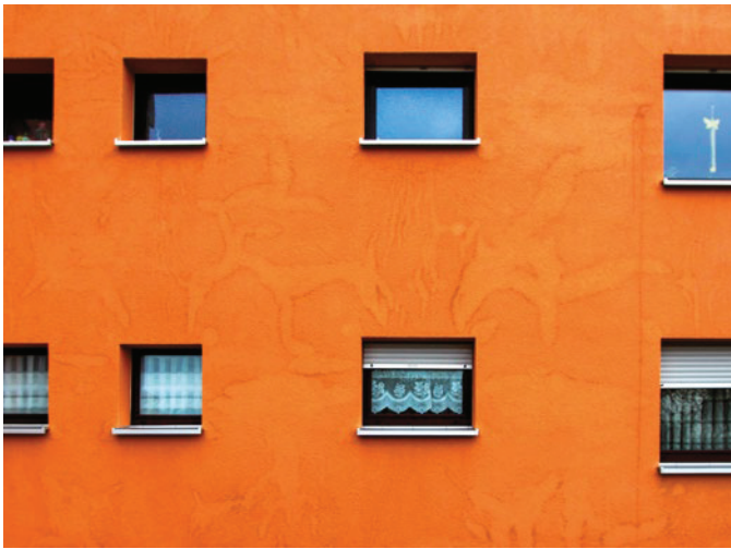
3 | Beispielobjekt Wohnhaus: Fassade mit Abzeichnungen (2015)
