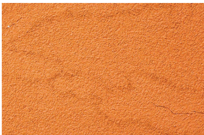
5 | Beispielobjekt Wohnhaus: Fassadenausschnitt mit Rissmarkierung (2015)
