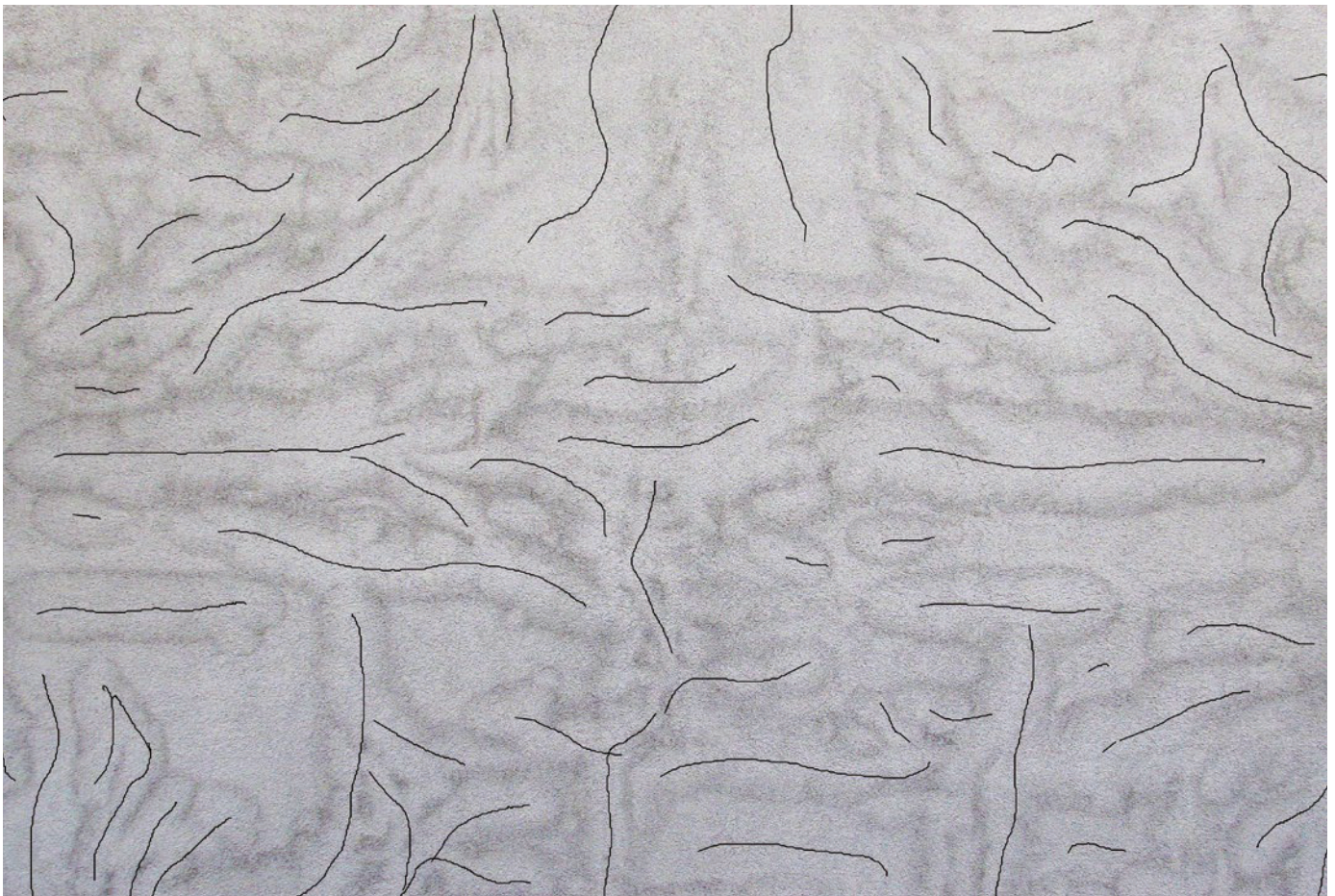
1 | Fassade mit Nachzeichnung der Risse
