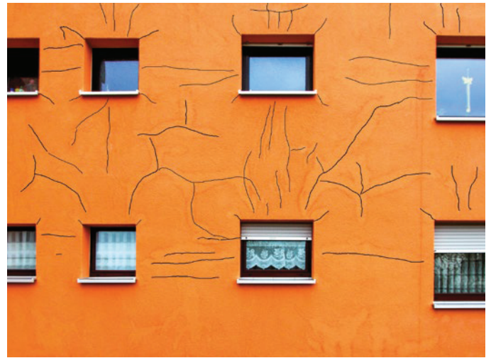
4 | Beispielobjekt Wohnhaus: Risse nachgezeichnet (2015)
